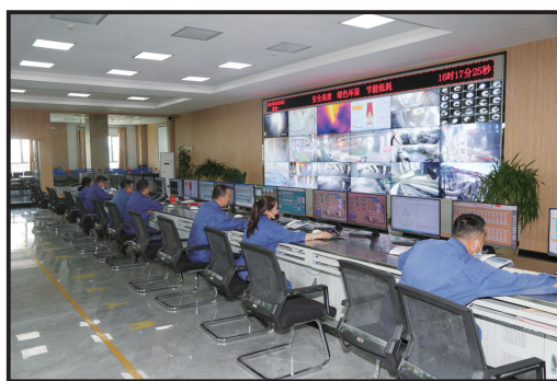
宽敞明亮的高炉主控室
