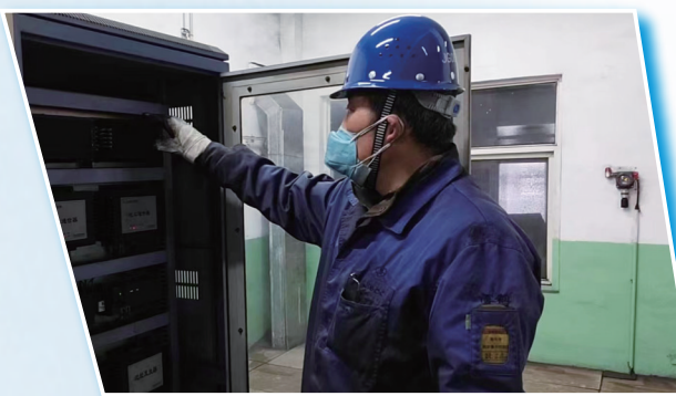
焦化厂职工检查静止无功发生器SVG补偿装置。段伟 摄
