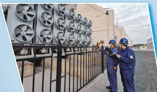
东兴铝业公司运行岗位人员对整流变压器油风冷却装置进行测温。谢毅 摄
