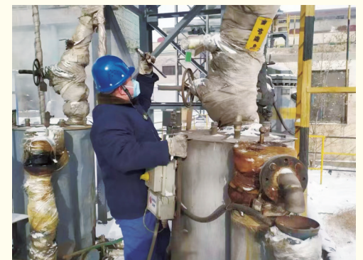
近日,宏兴股份不锈钢分公司连铸作业区进一步加强连铸设备防寒保温工作,逐个摸排检查煤气排水器及蒸汽管路,确保生产安全稳定运行。 白桦 摄
