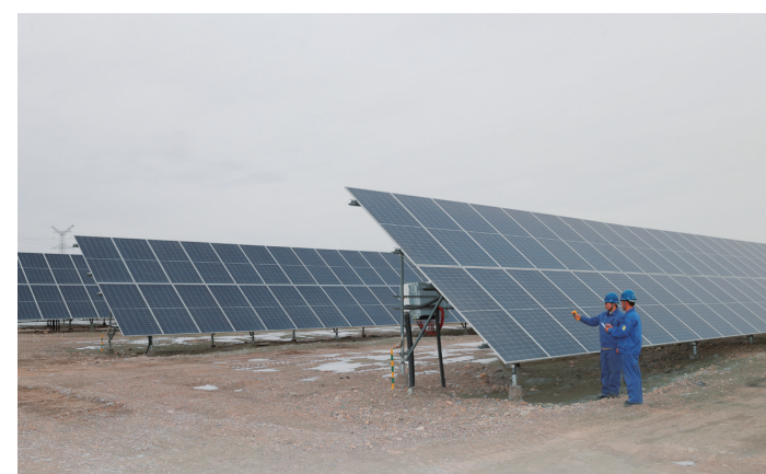
酒钢宏电新能源12MWp分布式光伏发电项目稳定运行。
