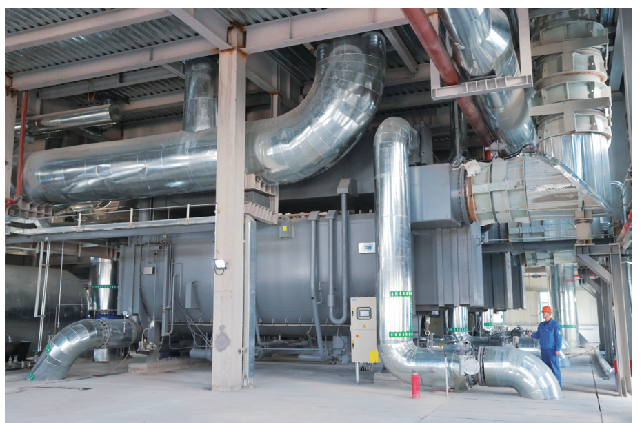
入冬以来,宏晟热电公司切实扛起能源供应任务,以加强热网设备点检和缺陷升级管控为抓手,不断夯实供暖设备安全稳定运行基础,全力以赴确保职工群众温暖过冬。图为该厂职工认真点检供热首站电气设备。张志方 摄
