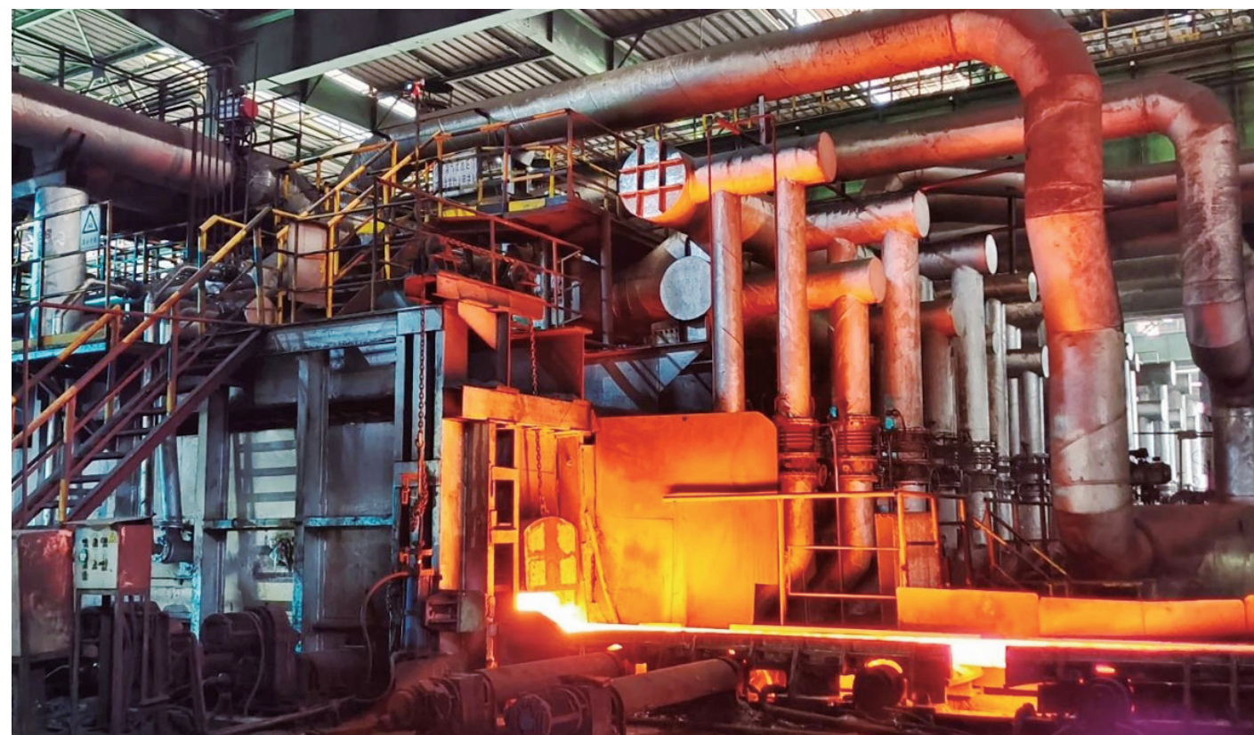
近日,宏兴股份公司炼铁厂棒线作业区大力开展加热炉二加热段加热温度优化试验,实施加热炉降低氧化烧损技术攻关,有效降低了加热炉氧化烧损率和吨钢煤气消耗量,为全厂降本增效工作贡献了力量。 摆永萍 摄
