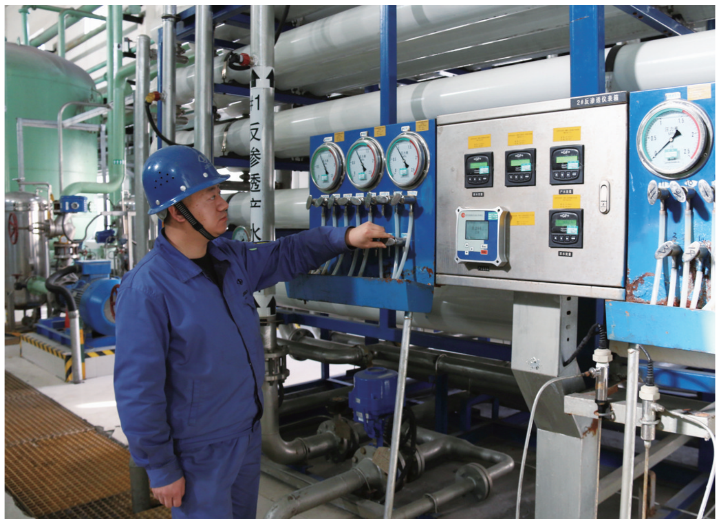
通过加强设备管线仪器点检、对设备系统阀门内漏缺陷检修处理、实施埋地水管查漏项目等措施,2023年,宏晟电热公司铝电4台机组生产水耗量同比下降28.72万立方米,为企业用好水资源和降本增效发挥了积极作用。图为职工点检阀门。 杜娟娥 摄
