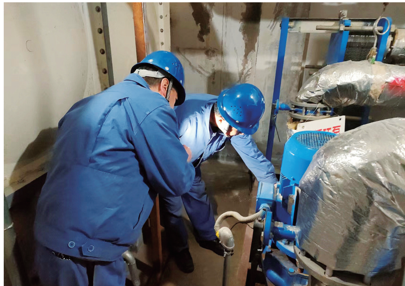
今年以来,兰州聚东长虹物业公司岗位人员每天对锅炉运行进行监控,根据天气适时调节出水温度,定期开展供热管网排查,及时解决跑冒滴漏问题。一季度共节约能源消耗成本28万元。 杜娟娥 吴婷 摄
