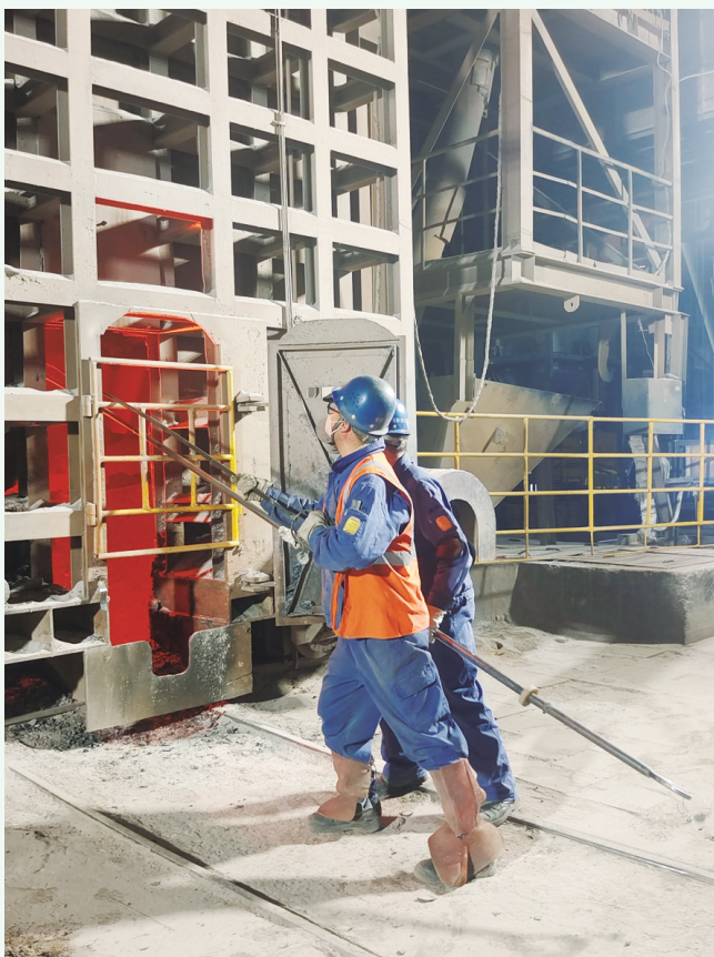
宏兴股份碳钢薄板厂炼钢作业区实施转炉后挡火门安全防护改造,用“方格”式防护门取代简易栏杆防护,有效降低了液态金属作业中的安全风险。王顺 摄
