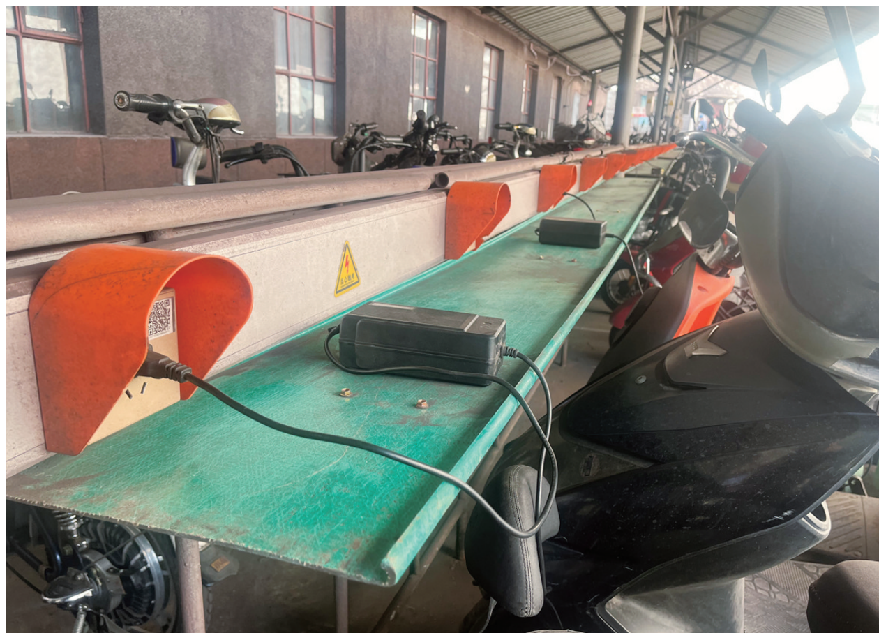
▲近日,宏兴股份选矿厂保障作业区设计安装了一款充电器放置平台。该平台采用绝缘玻璃钢材质,结构稳固,可有效防范因充电器过热引发的火灾。李彦杰 摄
