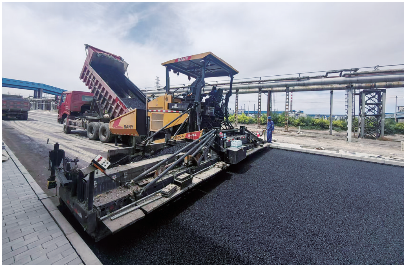
日前,工程技术公司建筑材料作业区铆足干劲加快推进冶金厂厂区道路改造项目建设。该项目在扩宽现有电16路的基础上,新建长为274米的电18路,建成后有效提高道路通行能力,更好地服务创业园周边单位。 温宝德 摄
