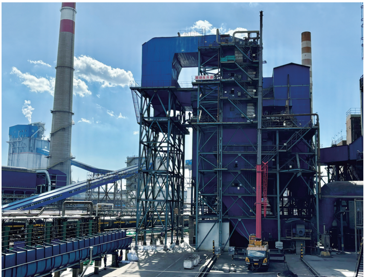
日前,宏兴股份宏翔能源公司三炼焦作业区高质量完成2736条耐高温布袋及配套龙骨的更换修复工作,将有效提高焦炉烟净化效率,提升脱硫系统催化剂使用寿命,节约人工成本约5.4万元。 张霞霞 黄靖 摄
