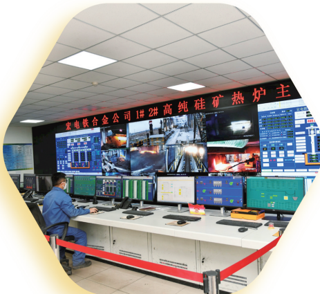
1号2号矿热炉主控室
