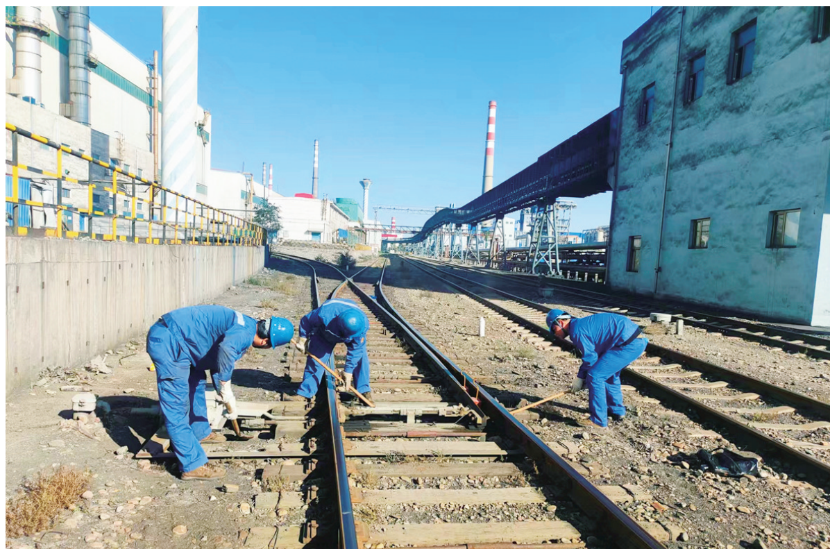
为保证冬季铁路运输稳定运行,近日,物流公司嘉东运输作业区职工对道岔防雪槽进行清理,作业人员按要求使用垫木等防护器具,携带对讲机和调度室加强联系沟通,确保现场安全。截至目前,已完成271组道岔防雪槽的清理工作。石浩年 摄
