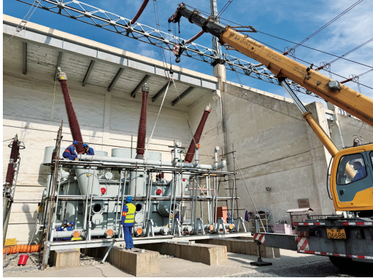
东兴铝业公司动力二作业区整流变压器本体。
