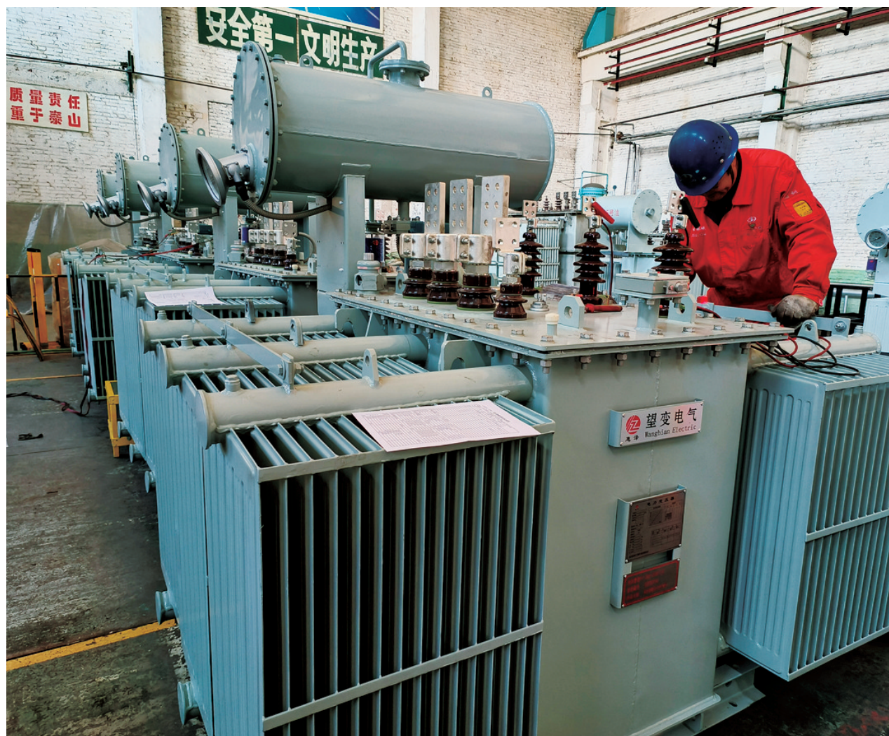
随着炼轧厂工艺装备提升及产品结构调整项目建设的推进,该项目配套的电机、变压器等关键设备陆续投入使用。近日,宏兴股份检修工程部电器修造作业区对该项目15台新高压电机、18台新变压器进行编号,并逐台检测验收,出具合格证及试验检测报告,实行统一管理,确保上线新电机运行稳定、状态可靠。 王文星 摄
