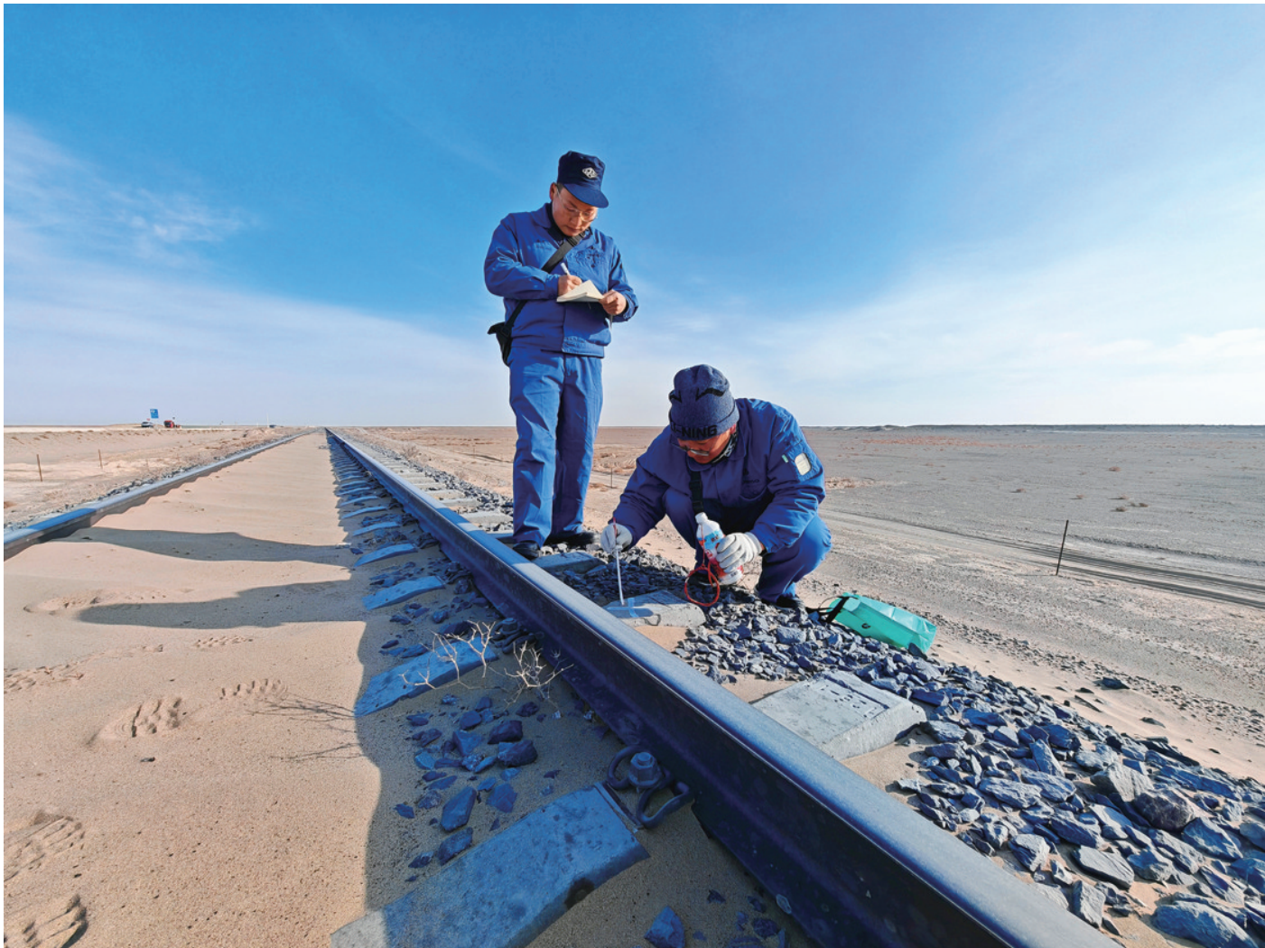
日前,物流公司中兴铁路公司联合兰州铁道设计院等单位对嘉策铁路部分区间线路的钢轨和砟枕开展伤损调查,对破损、掉块、表面龟裂的区域进行记录判别,提高嘉策铁路线路质量,确保铁路运输安全。
