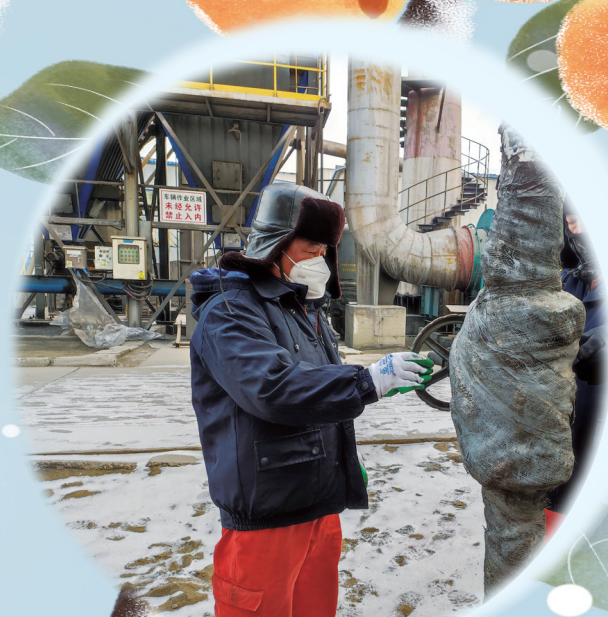
宏兴股份检修工程部不锈钢作业区职工不畏严寒开展检修作业。
