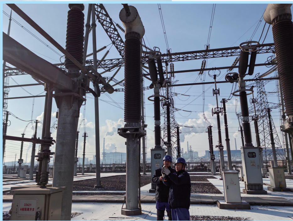
宏晟电热公司职工对330kV宏热五回线进行点检测温。
