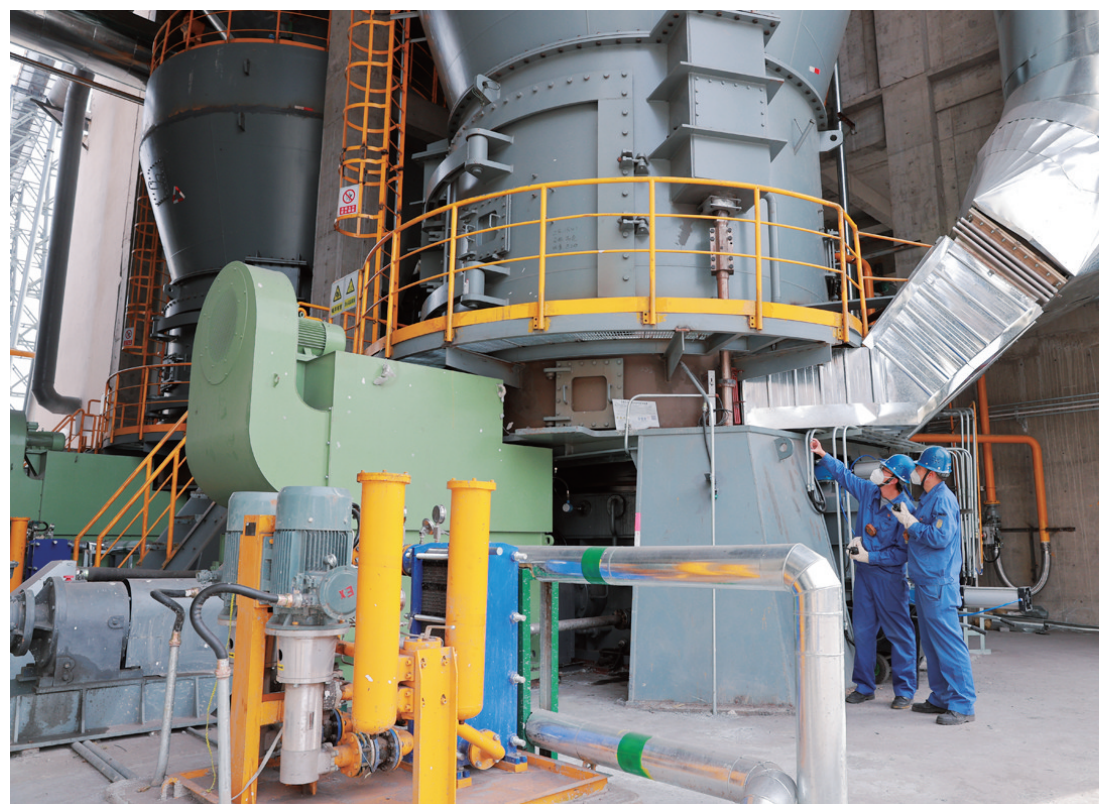
2024年,宏兴股份炼铁厂积极调整配煤结构,持续提高磨煤机加载压力,精细控制制粉系统风量,实现磨煤机台时产量、能耗以及煤粉质量等指标明显进步。图为该厂职工认真检查磨煤机设备运行情况。张立志 摄
