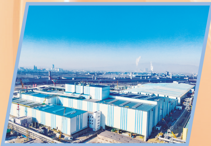
炼轧厂工艺装备提升及产品结构调整项目 炼钢连铸主厂房彩板安装工程
