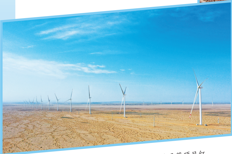
240万千瓦智慧电网及新能源就地消纳示范项目红柳泉一期200MW风电项目。 张志方 摄
