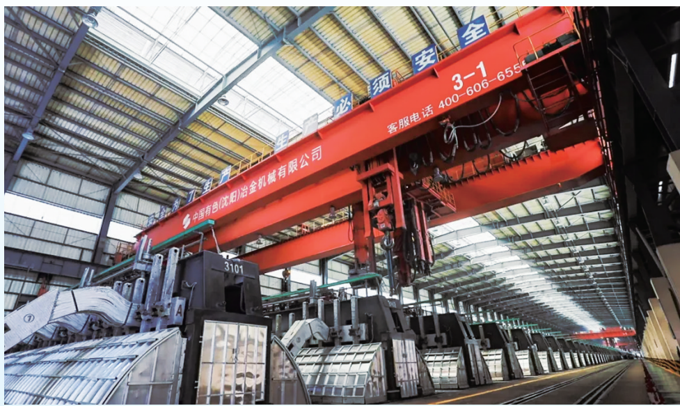
东兴铝业公司生产现场。
