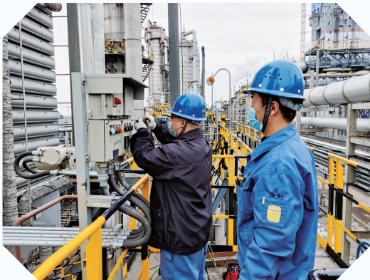
保障一作业区职工开展设备点检。
