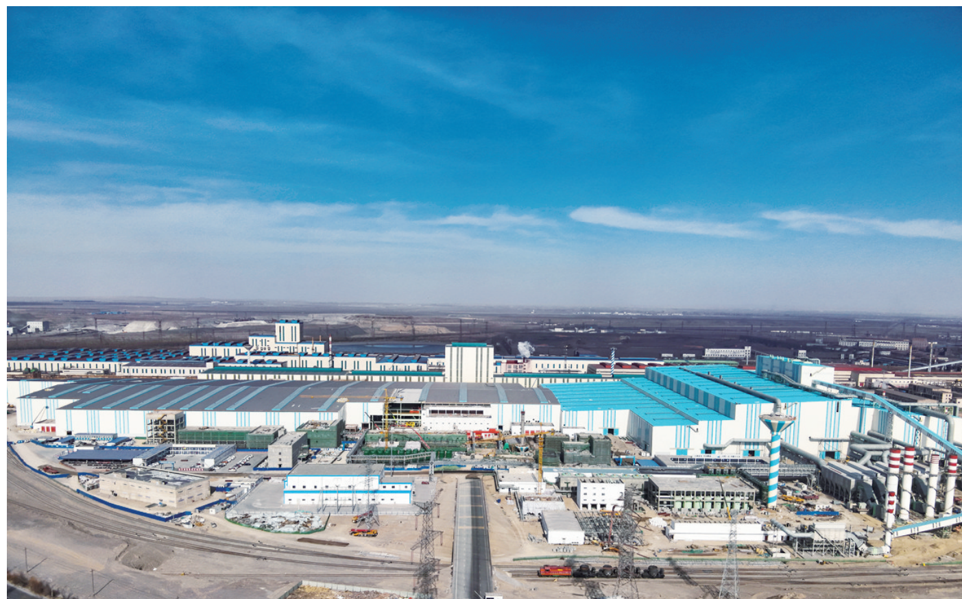
炼轧厂工艺装备提升及产品结构调整项目自启动以来,该项目紧盯目标任务,倒排工期、挂图作战,严格把控工程质量、安全和进度,顺利完成主厂房封闭、主体设备安装等建设内容。目前,该项目已如期全面复工,各项配套设施安装、调试任务按进度计划有序推进。郭俊 摄
