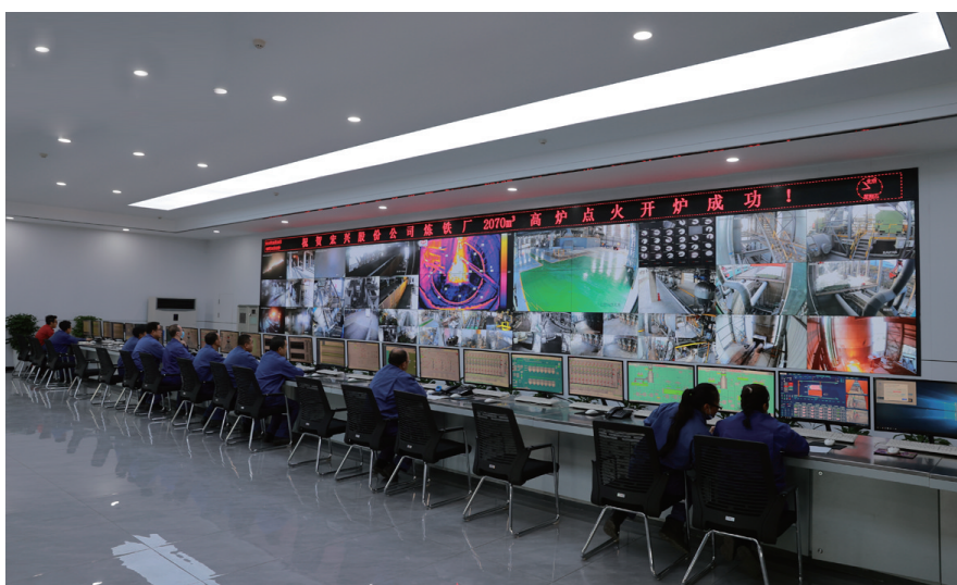
炼铁厂新3号高炉值班室。张志方 摄
