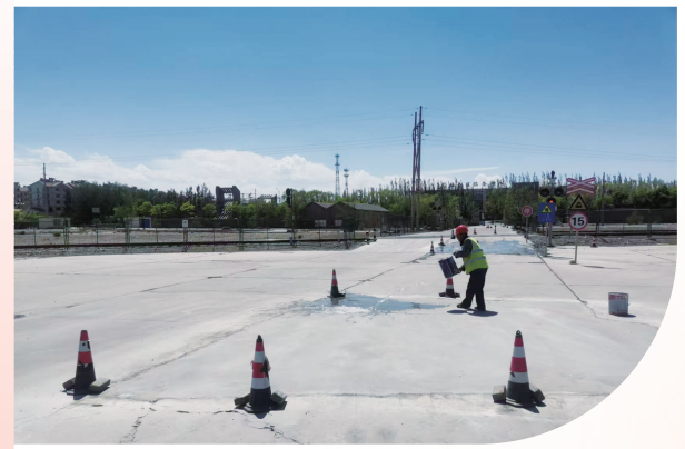
物流公司嘉峪关运营部工会把职工小事当大事。该部职工反映嘉峪关多式联运物流园部分路面因使用年限久存在破损，工会第一时间安排业务人员实地调查，推进破损道路维修硬化，改善了职工工作条件，以实际行动诠释“娘家人”担当，夯实“幸福小家”根基。胡善舒 摄
