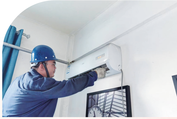
高温天气给生产一线各项工作带来严峻考验，东兴铝业公司嘉峪关电解三作业区迅速行动，为职工撑起“清凉伞”。该作业区对休息室的空调、风扇、冰柜等进行维护保养，确保设备正常运转，同时配齐防暑降温药品，方便职工随时取用，进一步提升了职工的归属感和幸福感。徐涛 摄
