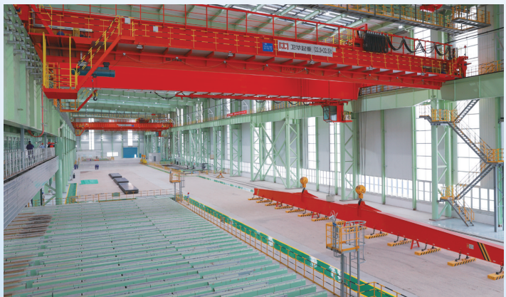
集成天车定位、激光测距等前沿技术,构建起全流程生产智能管控体系和可视化调度体系。
