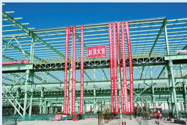
2024年9月,炼轧厂工艺装备提升及产品结构调整项目4200mm宽厚板厂房钢结构顺利封顶。
