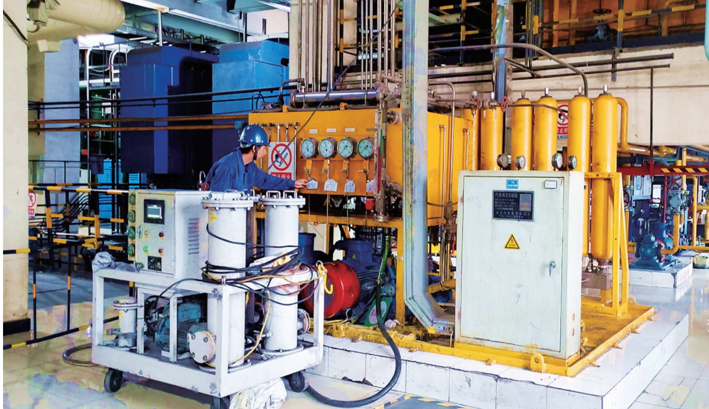
今年以来,宏电热电公司持续强化设备管理,合理安排设备检修时间,全力做好设备定检、巡检、改造等工作,确保生产持续稳定运行。8月份,该公司进一步提升机组运行负荷,单月增发发电量达5200万千瓦时,为业主生产提供了坚实能源支撑。 李淑芳 摄
