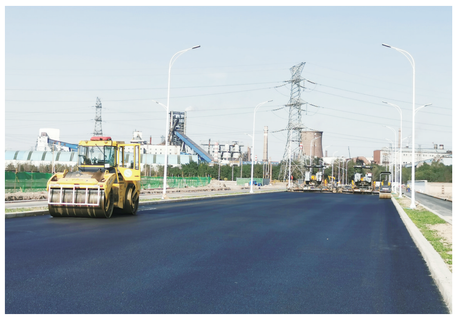
近日,由工程技术公司建筑材料作业区承建的酒钢厂区开拓门及环厂西路拓宽改造工程顺利完成面层摊铺作业,标志着工程取得阶段性进展。 李旭文 丁晨晨 摄
