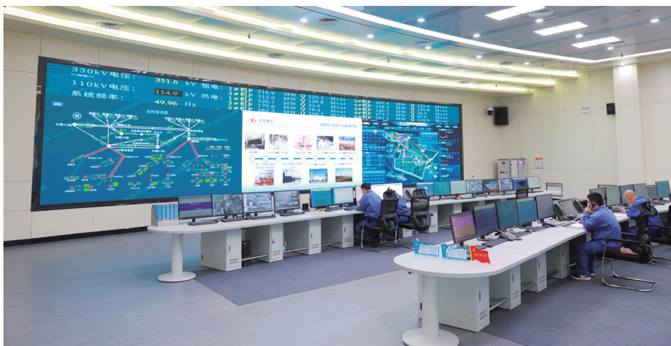
酒钢能源智慧管控中心自正式投用以来,一方面依托“源—网—荷”全链路数据、智能算法及协调自动控制,实现了电网“源”“荷”精准预测与实时平衡;另一方面通过精细化调度、标准化管理及严格监督,不断夯实电网规范运行基础,保障了酒钢电力系统持续稳定运行。张立志 摄
