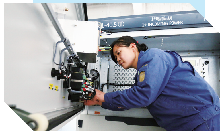
宏联自控公司职工检查配电柜。
