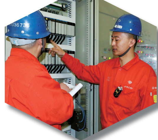
监控设备运行状态。
