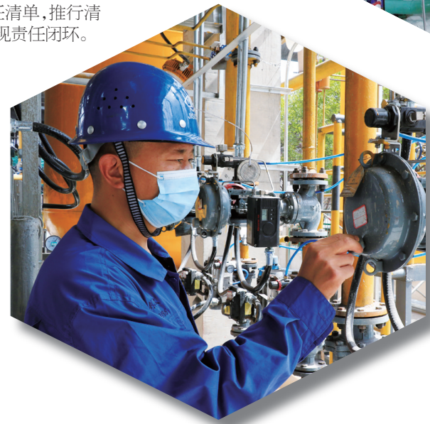
检查高炉设备。
