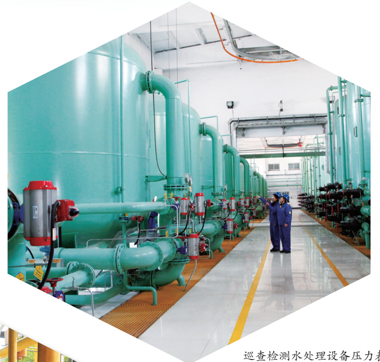
巡查检测水处理设备压力表。
