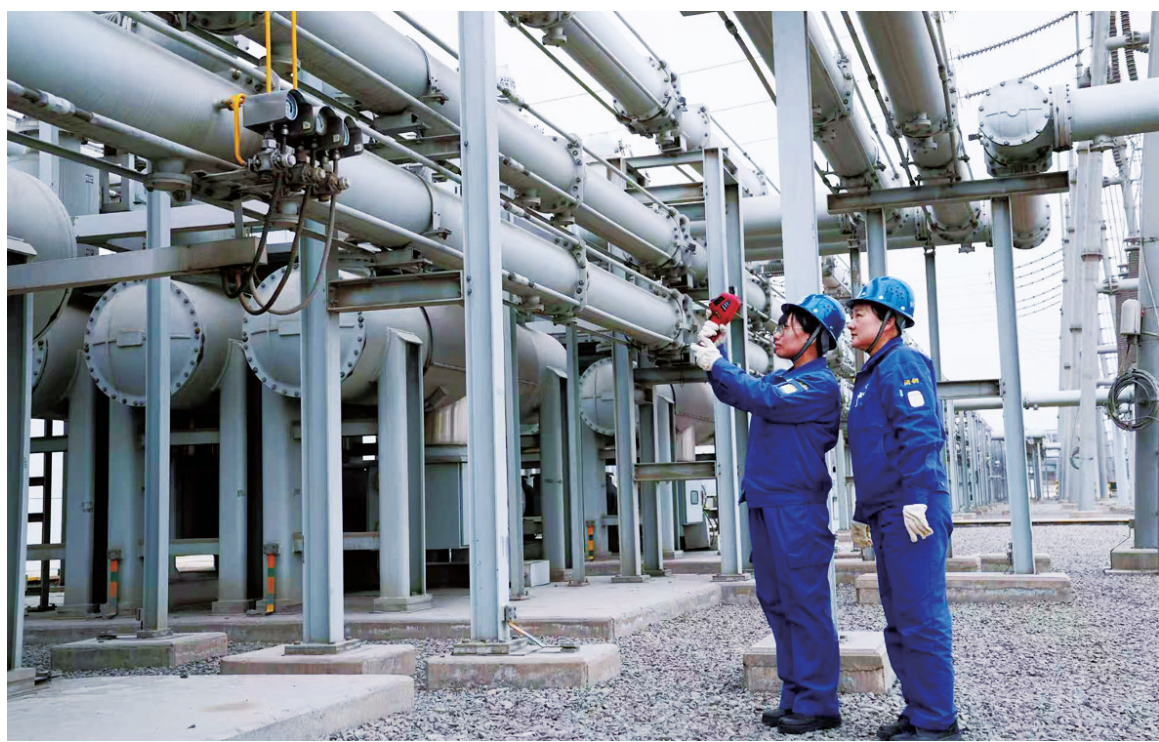
今年以来,宏晟电业公司电网运行作业区严格遵循设备点检及运行管理标准,针对保护装置、变压器、电容器、大线接头等关键设备,实施差异化巡检,切实保障供配电系统安全稳定运行。 张志方 摄
